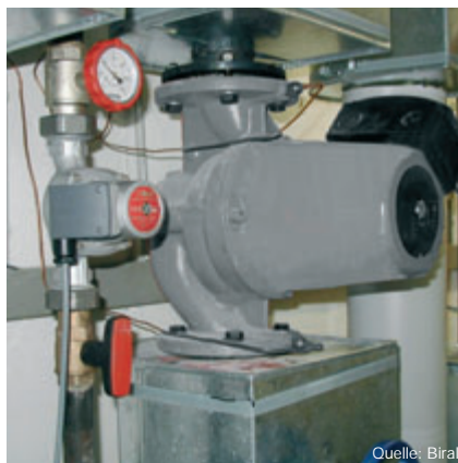
Bild 10 Pumpenaustausch durch richtig ausgelegte Magnetmotorpumpe
